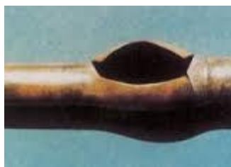
Poškodené medené potrubie vplyvom tlaku.
