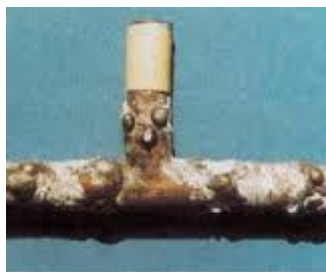
Poškodené medené potrubie z vonkajšej strany.
