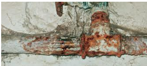
Poškodené skorodované ocel'ové potrubie.
