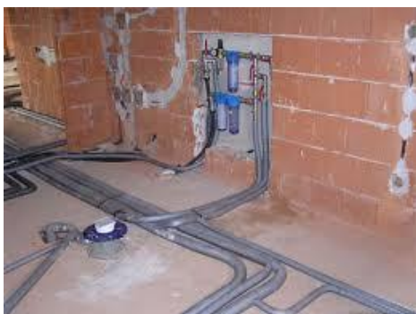
Vnútrotný rozvod vody s izoláciou.
